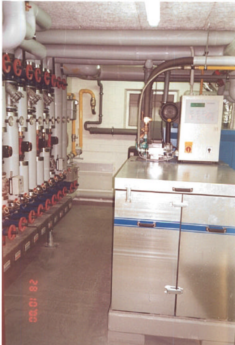
Blick auf das kompakte „Klein“-BHKW-Modul
