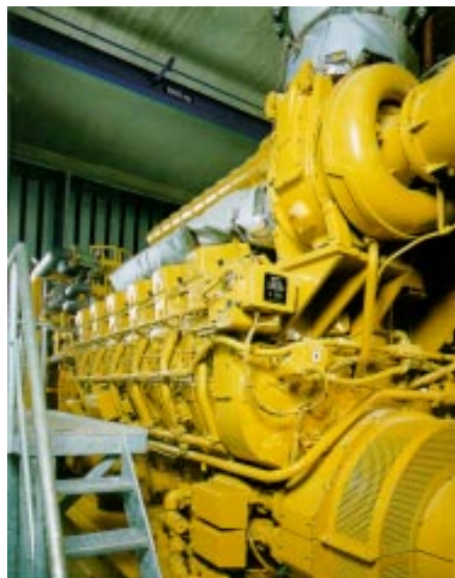
Abb.7: Motor-BHKW Zeppelin CAT
